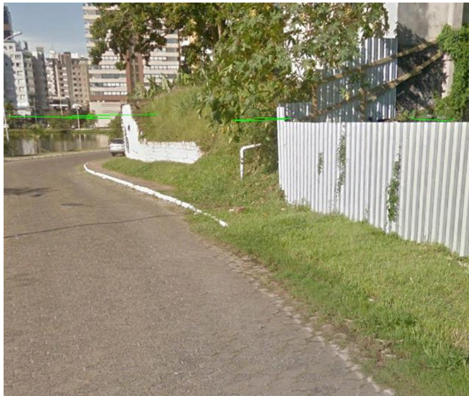
Figura 8 - Calçada em mal estado de conservação e com obstáculo
